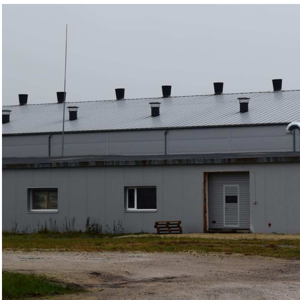
2.12.1. attēls. Esošās dējējvistu mītnes jumta ventilācijas izvadi
